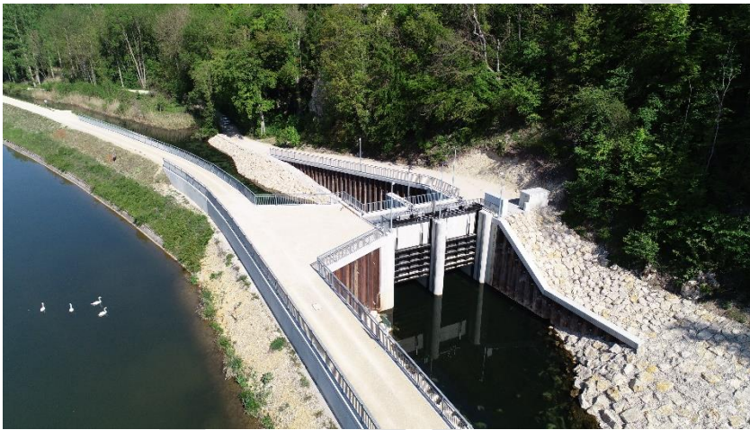
Auslaufbauwerk mit Finkensteingerinne zur Polderentleerung (Quelle: Wasserwirtschaftsamt Ingolstadt)
